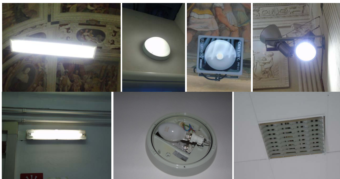
Figura 4.13 - Particolare dei corpi illuminanti
