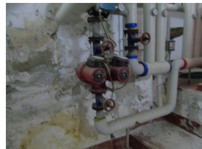
Figura 8.5 – Particolare circolatori da sostituire
