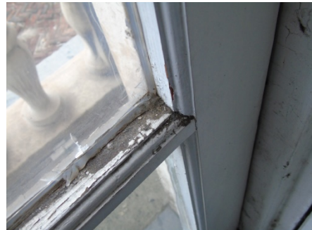
Figura 8.3 - Particolare serramenti da sostituire
